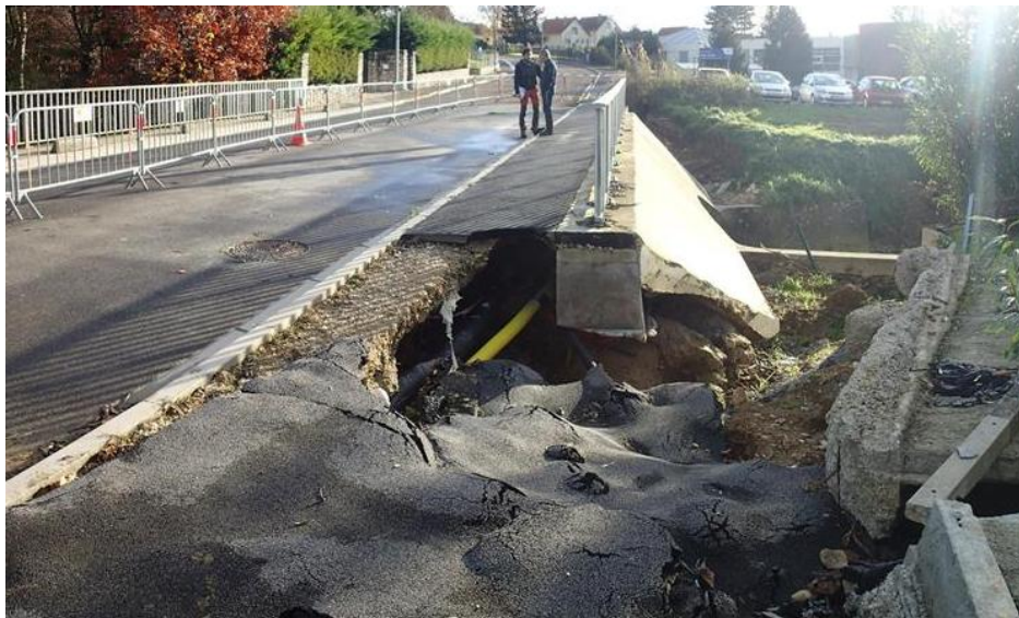
Figure 7 : Dégâts infligés au pont de la rue Robert Legraverend par la crue d'août 2024 (source : Artelia)
