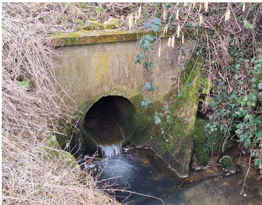
Figure 14 : Exemple de canalisation observée sur le sous-bassin versant ChB_1 (source : Artelia)
