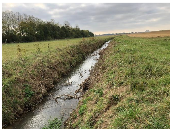
Figure 43 : Rémanents laissés dans le lit de la rivière et absence de ripisylve après intervention de l'association foncière
